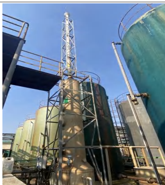
盐酸储罐废气处理设施
