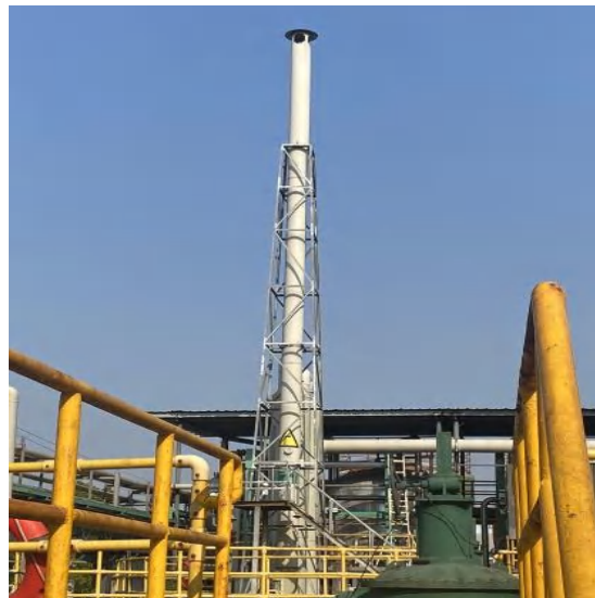
污水站无组织废气处理设施
