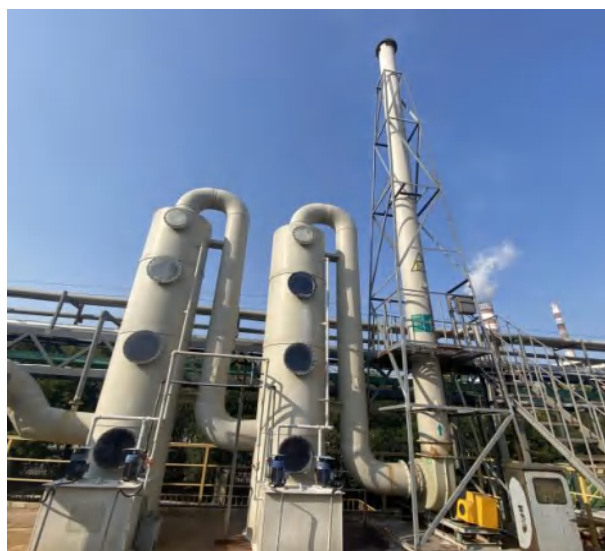
污水站有组织废气处理设施
